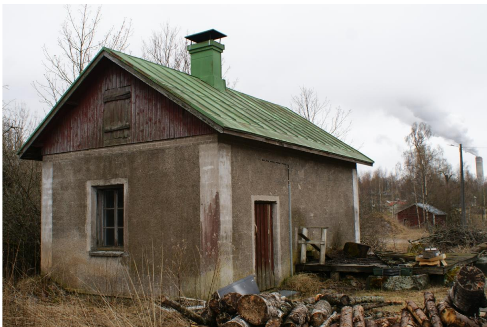
Kuva: Rapattu, betonitiilirunkoinen sauna on 1900-luvun puolelta. Päätykolmiot ovat lautta, harjakaton vesikate on saumattua peltiä. Terrassin kohdalla seinässä on kosteusvaurioita.
